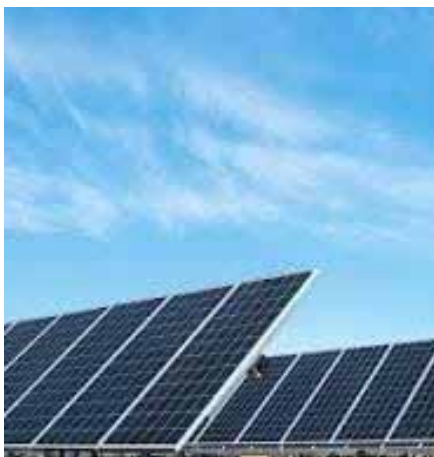
Paneles Solares comunitarios
